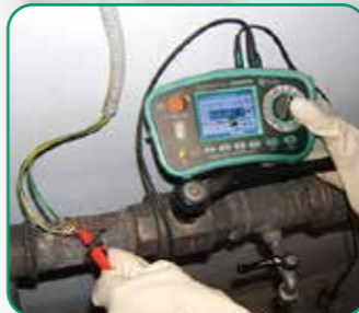
Continuity check of equipotential bonding
